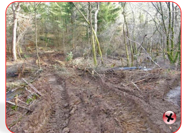
Les rémanents sont recouverts de boue et désormais inefficaces = apports de sédiments au cours d'eau
