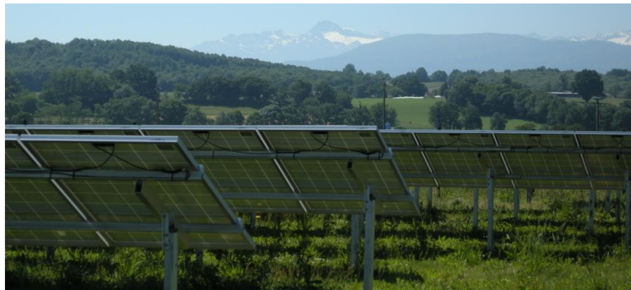
Photographie 1 : Parc solaire photovoltaïque de Saint-Martory (31)
