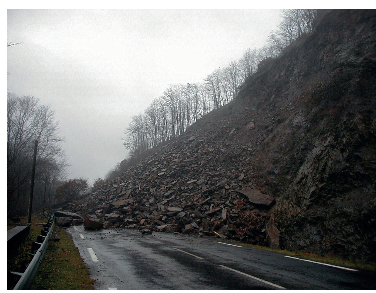
Lapeau, novembre 2003, éboulement sur RD16
