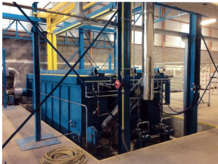
Figure 19 : Exemple de bains de traitement de surface de l'aluminium (par trempage)
