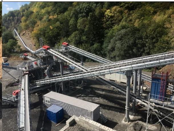
Cribles secondaire et tertiaire
