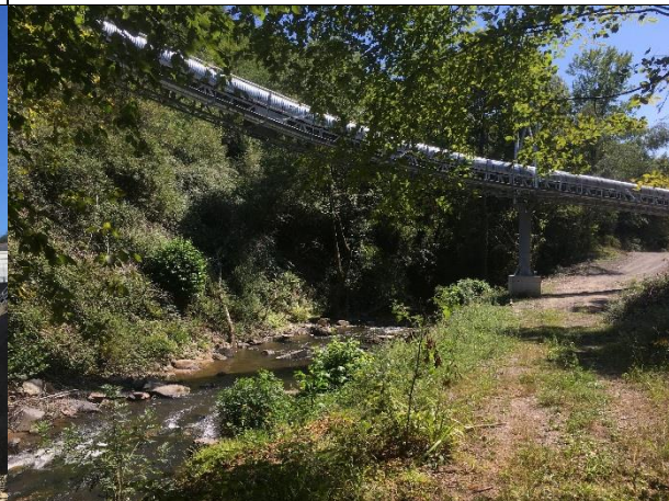
Bande transporteuse – passage au-dessus de La Loyre
