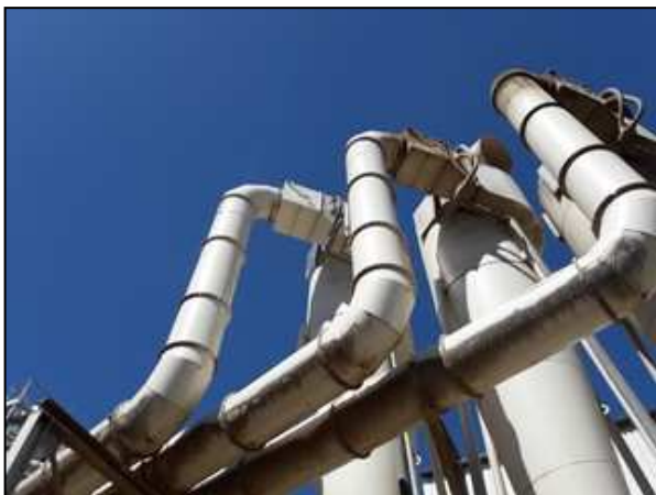
Clapets anti-retour sur cyclones
