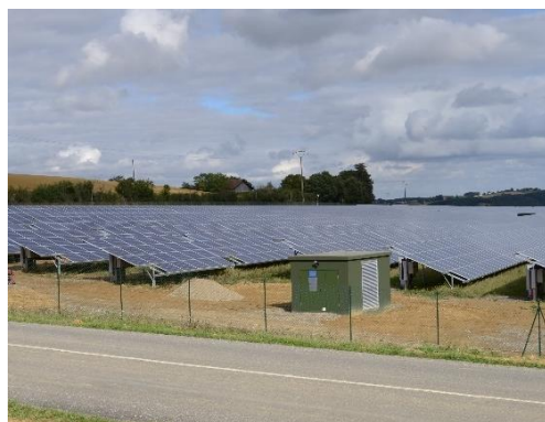
Exemple de poste de transformation sur un parc solaire (Luxel)
