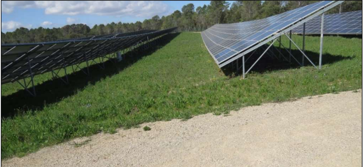
Reprise du couvert végétal sous une centrale PV ENGIE Green
